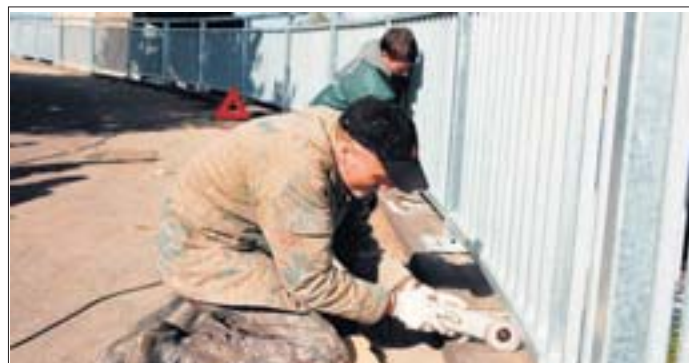
Unscheinbar, aber fleißig, wird an der Brücke gearbeitet. Die komplette Maßnahme wird rund drei Millionen Euro kosten.
